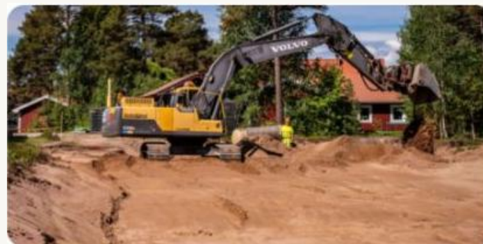
Ledningar i mark
